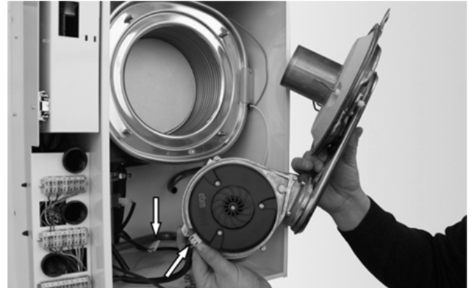
Abb. 31: Netz- und den Steuerstecker sowie demontierte Brennereinheit
